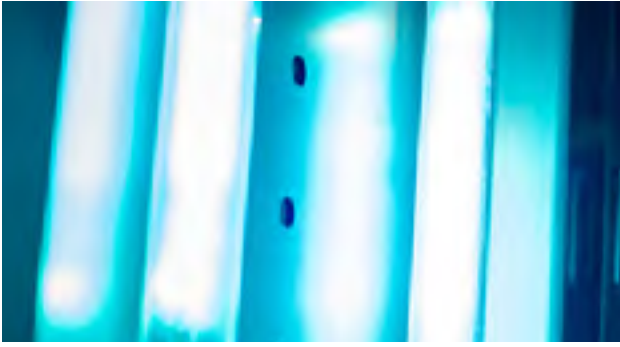
Los tubos UV-C se usan desde hace varias décadas para la esterilización de los vagones del metro de Moscú.
